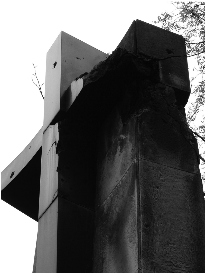
4. Pomnik – ołtarz, na ramieniu krzyża widoczne ślady zniszczeń z 1939 r. (stan z 2003 r., fot. Agnieszka Stachnik).
